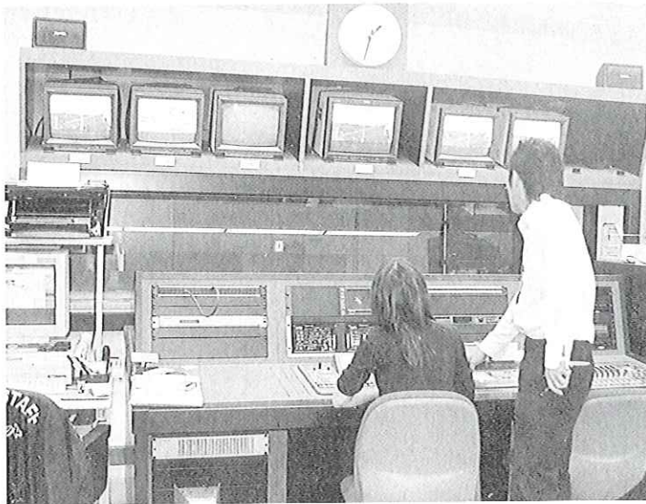
ケーブルテレビ調整室 (温泉総合支所)
