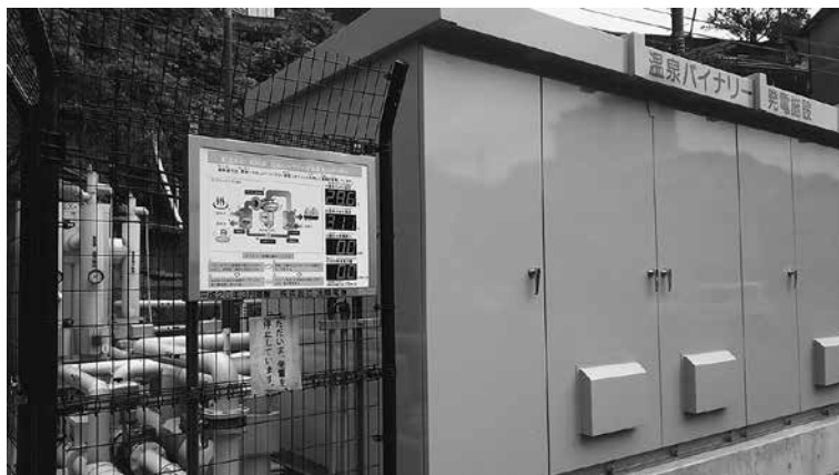
故障続きのバイナリー発電機。当初説明には無かった収支の不合理な状態が続いている。
