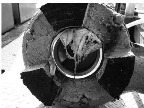
中継ポンプに布が絡んで故障
